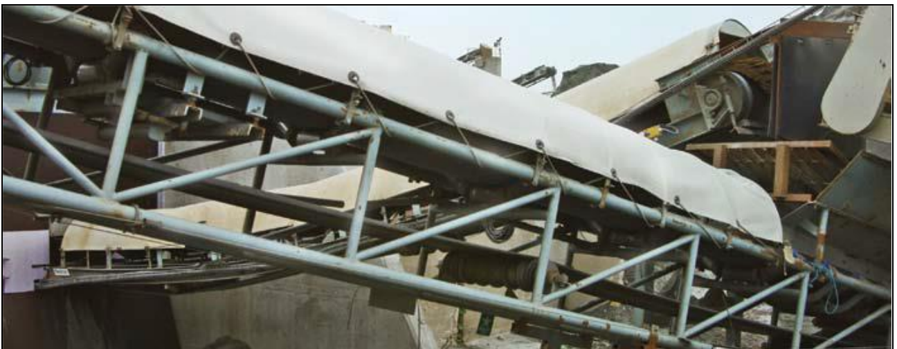
Figura 3 - Exemplo de correia transportadora de agregados coberta (NAPA, 2012)
